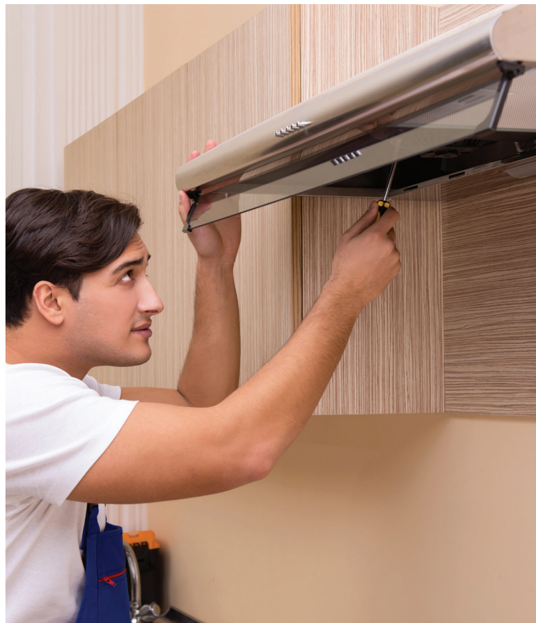
Kitchen exhaust fan
